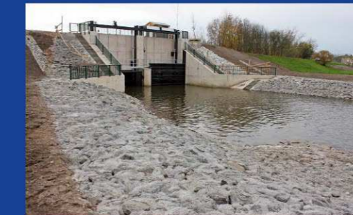
Betriebsauslass mit zwei Rahmendurchlässen zur Ableitung.
